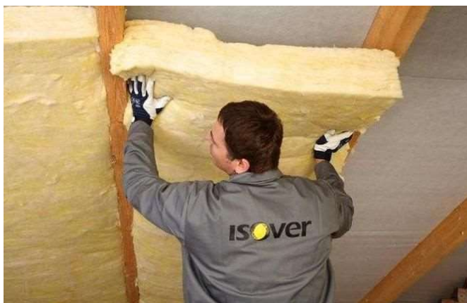
Slika 7: Postavljanje toplotne izolacije od mineralne vune na kosom krovu, sa unutrašnje strane
