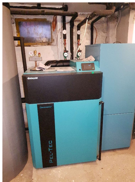
Slika 16: Izgled kotla na pelet instalisanog u podrumskoj prostoriji individualnog objekta
